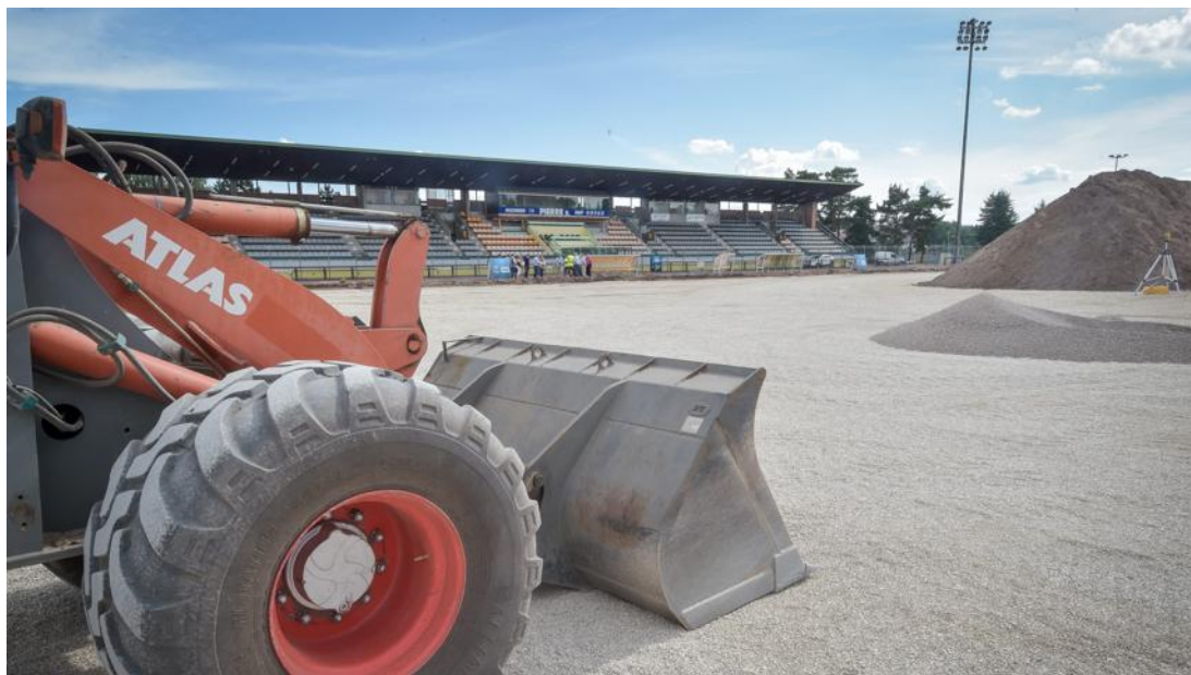
Le terrain d'honneur de la Colombière a des airs de chantier en zone minière. Mais pas d'inquiétude : à la mi-septembre ce sera à nouveau un beau stade engazonné. Photo Jérôme HUMBRECHT
